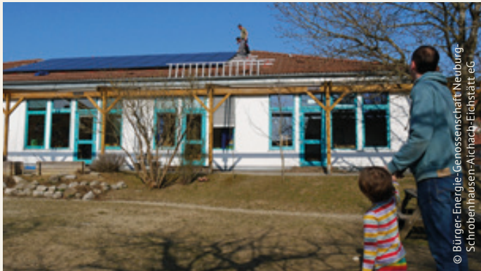
Ein aktiver Beitrag zum Klimaschutz unter direkter Bürgerbeteiligung: Die Bürgersolaranlage auf dem Meringer Kindergarten Kapellenberg
